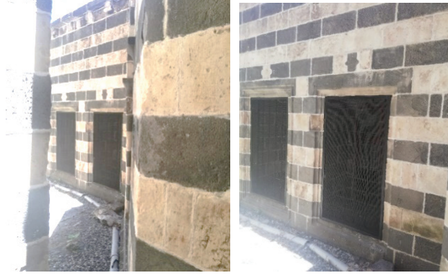
Şekil 12. Türbedeki Zemin Suyunun tahliyesini sağlayan PVC Borular (2021)
