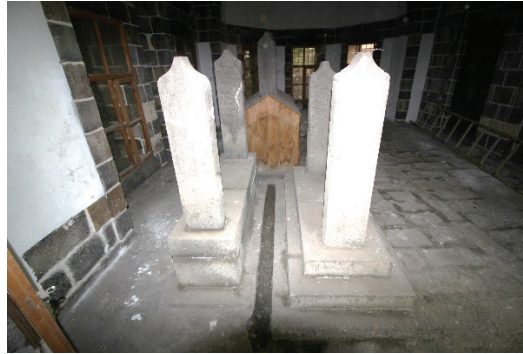
Şekil 9. İkinci Türbe Zeminindeki Nemlenme, Kot Düzensizliği ve Sandukada Çürümeye Bağlı Bozulmalar (2021)
